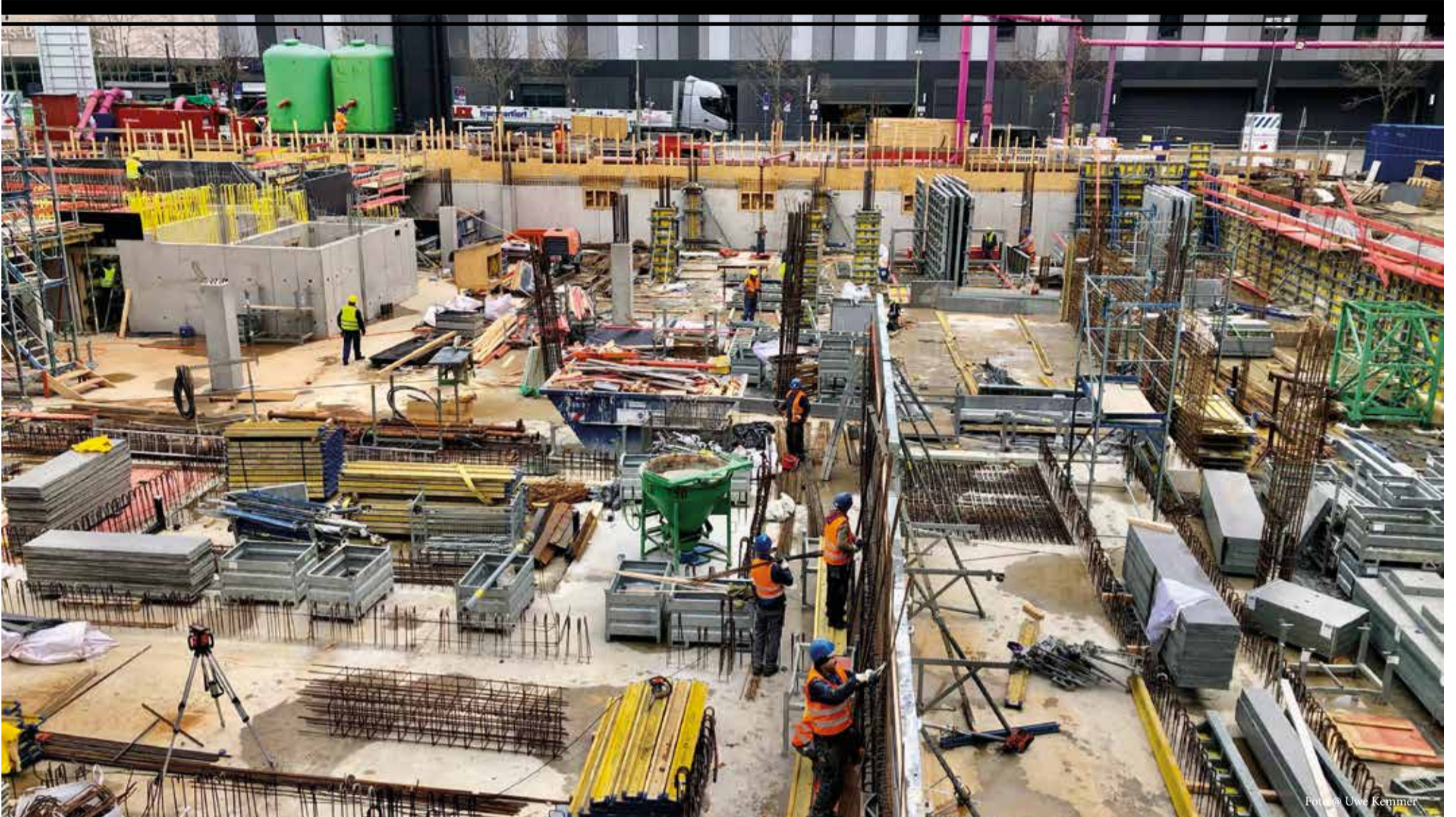
Großbaustelle Berlin: Jährlich statet ClimaLevel über 1.000 Wohnungen in der Hauptstadt mit Flächenheizsystemen aus.
