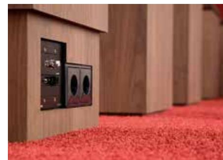
Im hochgefahrenen Zustand sind alle Anschlüsse zugänglich, um Geräte ans Netzwerk und die Präsentationstechnik anzuschließen.
