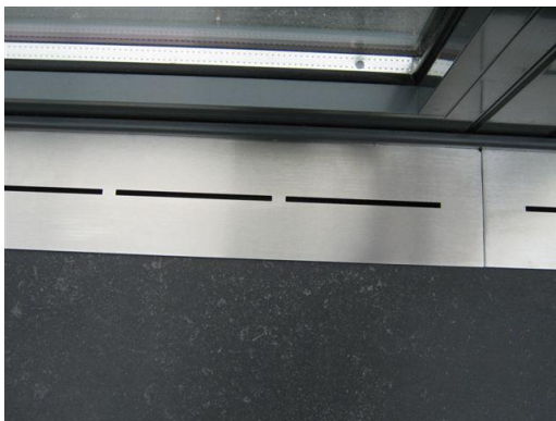
Abbildung 9: ESL Schiene als Luftauslass
